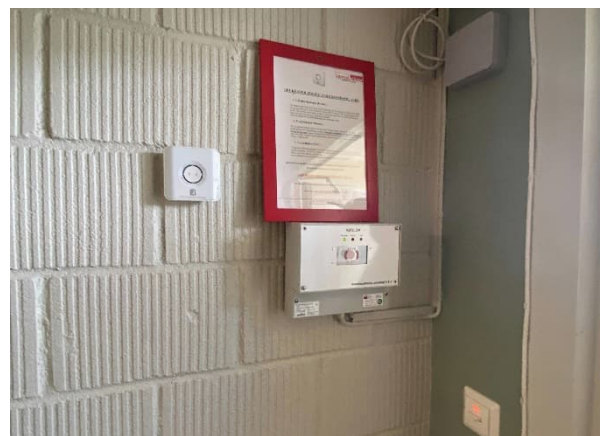
Sentral for røykventilasjon
