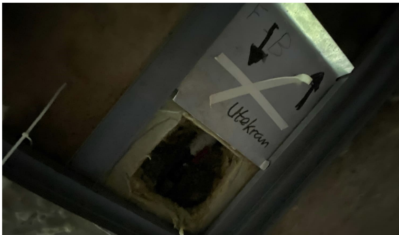
Utvendige stoppekraner i garasje er merket
