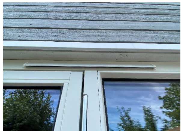
Ventil i vindu på småhus
