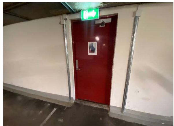
Branndører i stål, og med dørpumper
