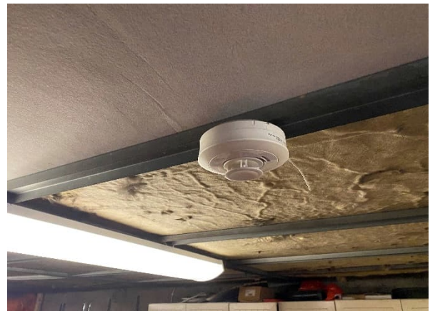
Brannmelder i garasje
