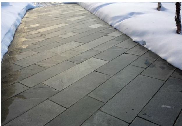
Eksempelbilde på snøsmelteanlegg
