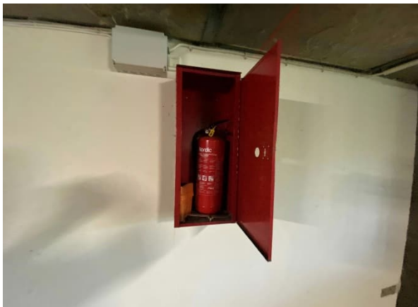
Brannslukningsutstyr i garasje
