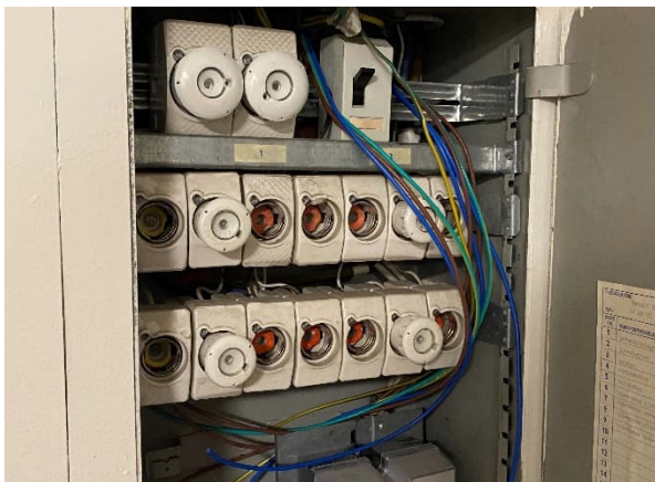
Leilighetsfordeling med skrusikringer og feilmom
