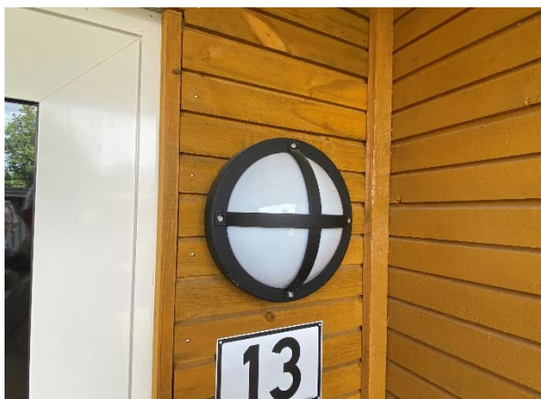
Utvendig vegghengt belysning
